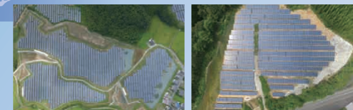
千葉県香取発電所
